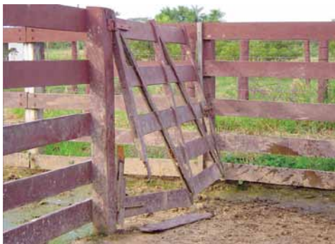
INSTALACIONES EN MAL ESTADO DE CONSERVACIÓN
