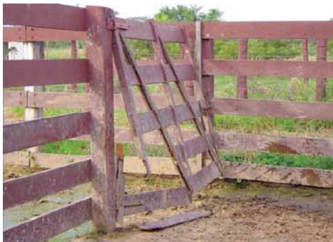
INSTALACIONES EN MAL ESTADO DE CONSERVACIÓN
