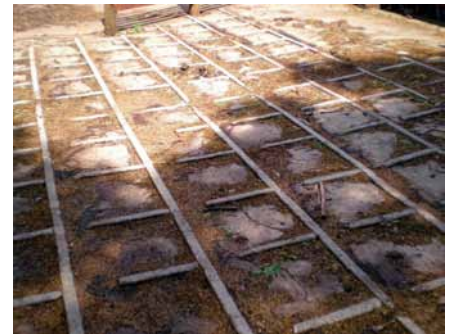
EL PISO DEBE TENER ESTRUCTURAS ANTIDESLIZANTES PARA EVITAR RESBALONES Y CAIDAS
